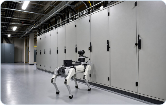
配电柜热成像巡检 场景示意 识别温升、发热与设备异常
